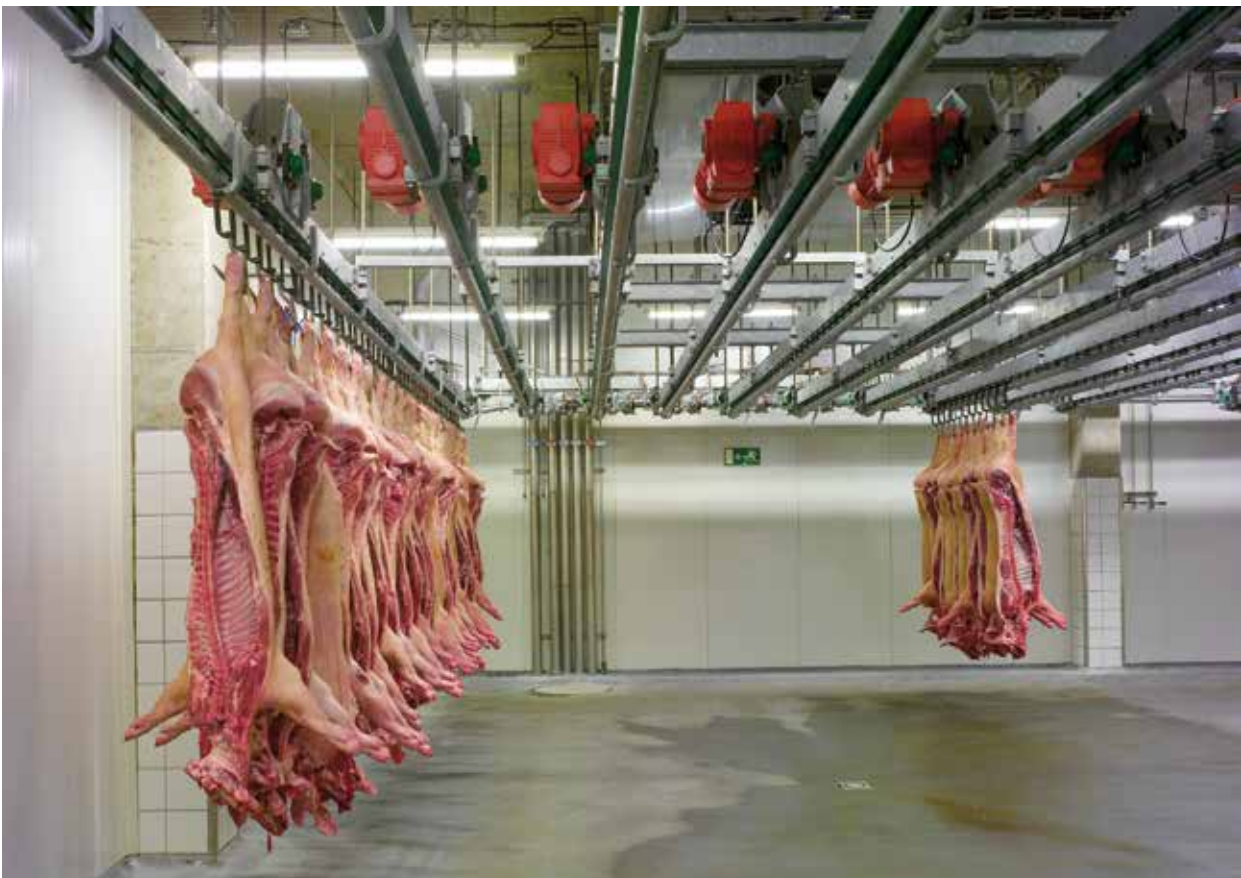
> NORKA-Leuchten BITBURG mit IP 69K im Kühlhaus eines Schlachthofs in Deutschland
